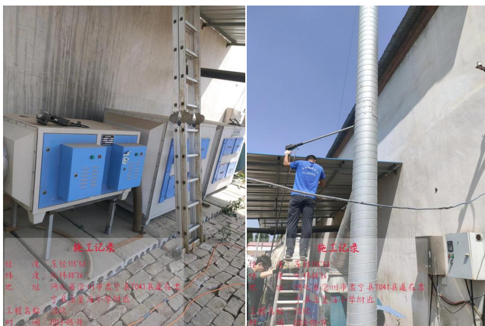
图 3-1 废气治理设施现场图
