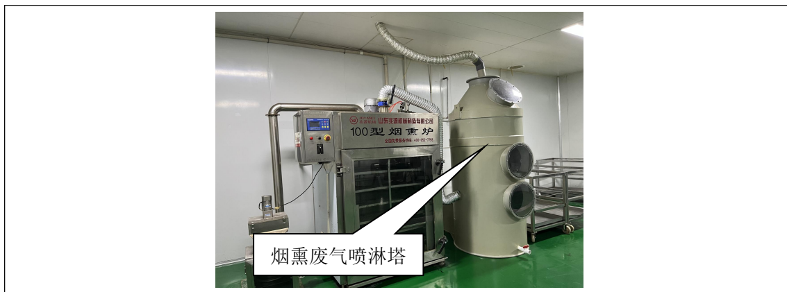
图 3-1 废气治理设施现场照片
